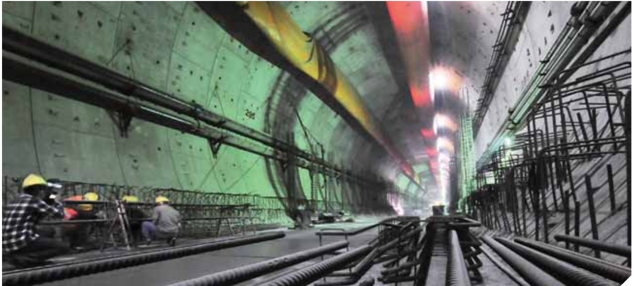
南京纬三路过江隧道工程采用高效节能、使用寿命长的LED灯用于隧道施工照明，节约成本80余万元
